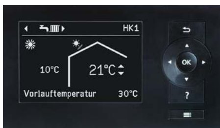
Display der Wärmepumpenregelung Vitotronic 200
