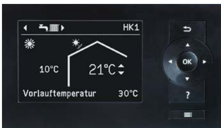
Display der Wärmepumpenregelung Vitotronic 200
