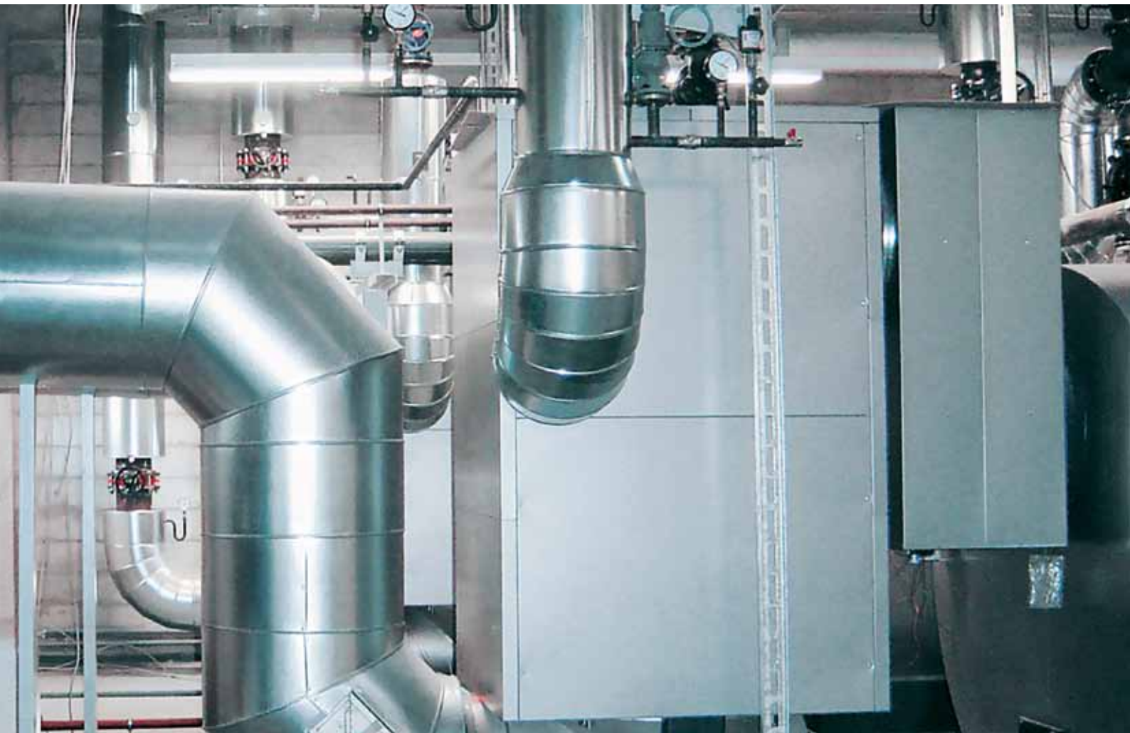
Nachgeschalteter Vitotrans Wärme- tauscher an einem Vitomax Kessel
