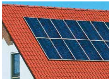
Vitovolt Photovoltaik-Module von Viessmann liefern auch noch bei teilweise beschatteten Flächen einen hohen Ertrag zur Stromerzeugung.
